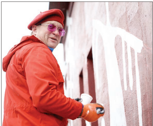
STØDIG PÅ HÅNDEN: Det ble riktig nå flott på trafoen i Bossekop etter at arbeidet var ferdigstilt.
